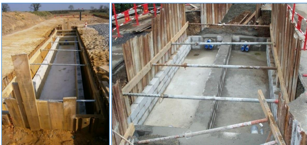
Figure 13 : Chambres de jonction (à gauche : liaison simple ; à droite : liaison double)
